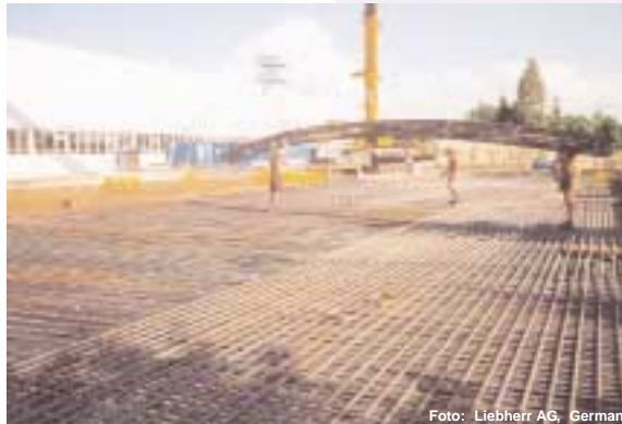
Bei einer Verlegung mit dem Autokran macht sich die Kombination von Abladen und Verlegen besonders bemerkbar. The combination of unloading and placing the mats in one step is especially economical.
