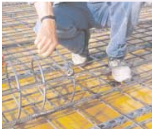
Die Demontage der Spirale reduziert sich auf das Aufzwicken von Bindedraht The dismantling is reduced to the cutting of the binding wire
